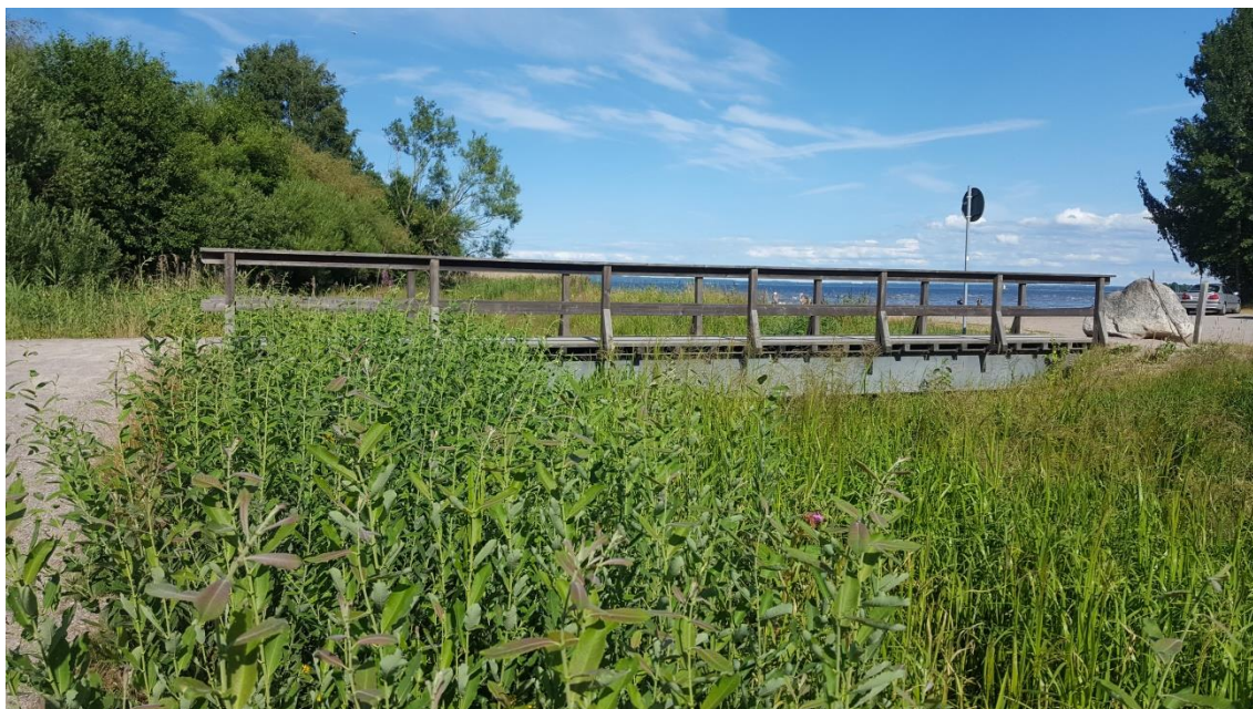
Figur 4. Gångbro över Toftabäcken, objekt A, med igenväxt bäckfåra. 19 juli 2017.
