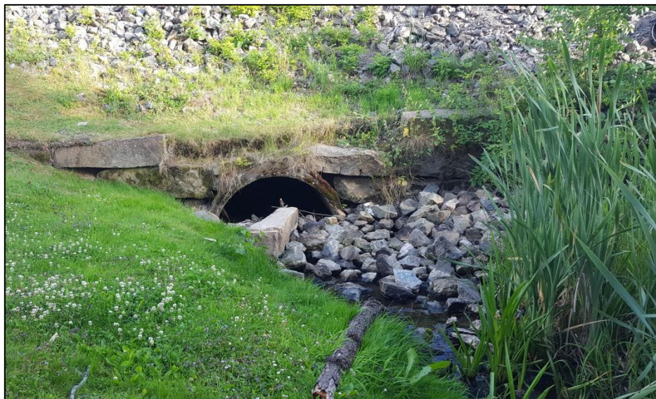
Figur 11. Trumma för Vinningabäcken under väg 2701. Kapaciteten är kraftigt påverkad av sten från vägens underbyggnad som har hamnat i vattendraget.
