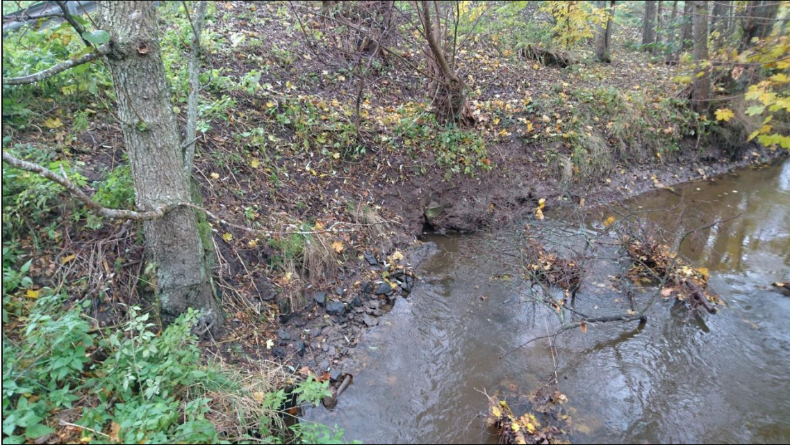
Figur 15. Erosion i den östra slänten i Öredalsån precis uppströms cykelbron norr om väg 44.
